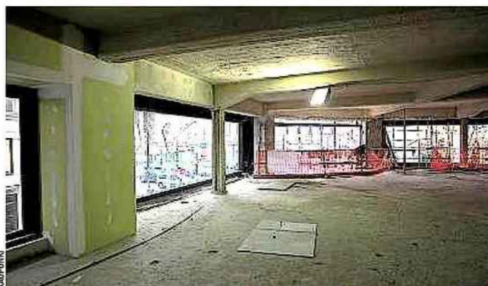
D'ici à l'été, le chantier (en b.) du Madeleine doit laisser place aux commerces.
